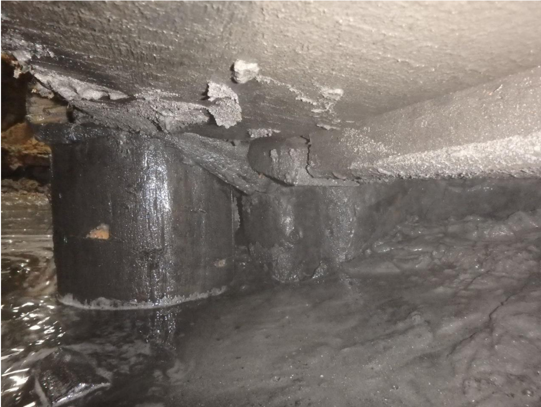
Foto van gebroken kesp onder de bouwmuur
