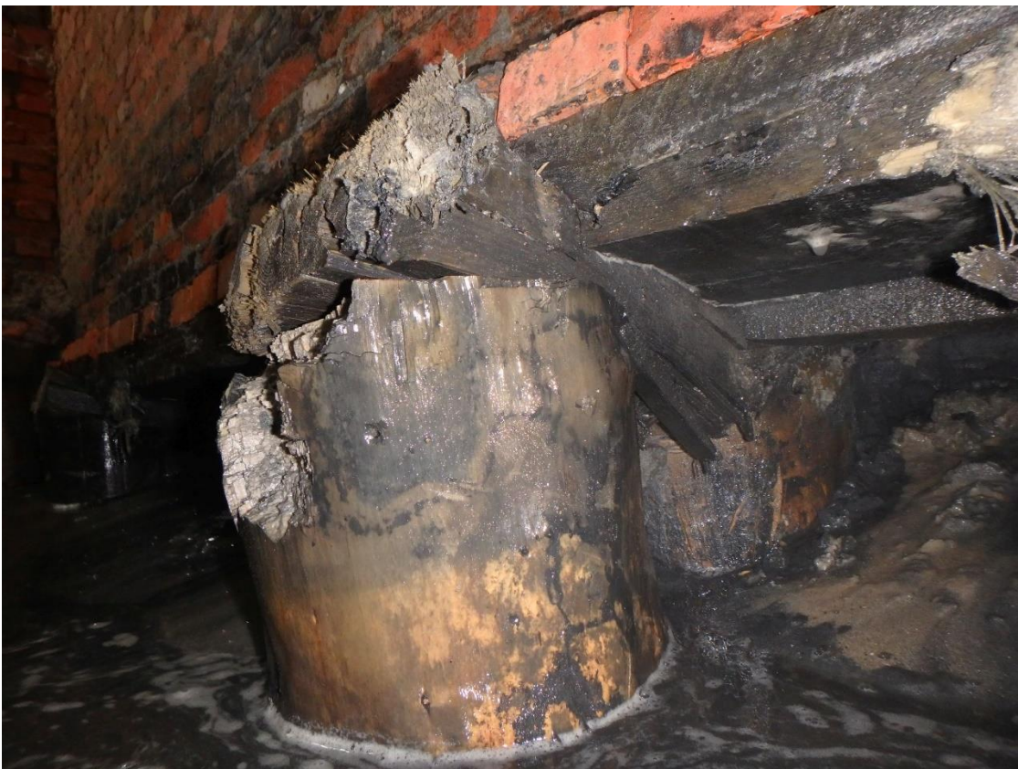
Foto van gebroken kesp onder de bouwmuur
