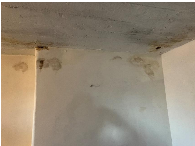
Vochtplekken op het schoorsteenkanaal/ plafond
