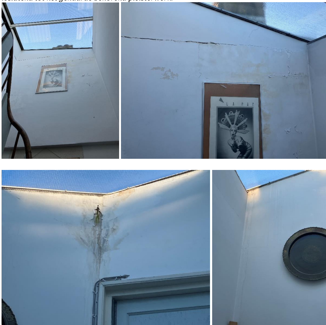
Lekkageplekken en scheurvorming in het trappenhuis
