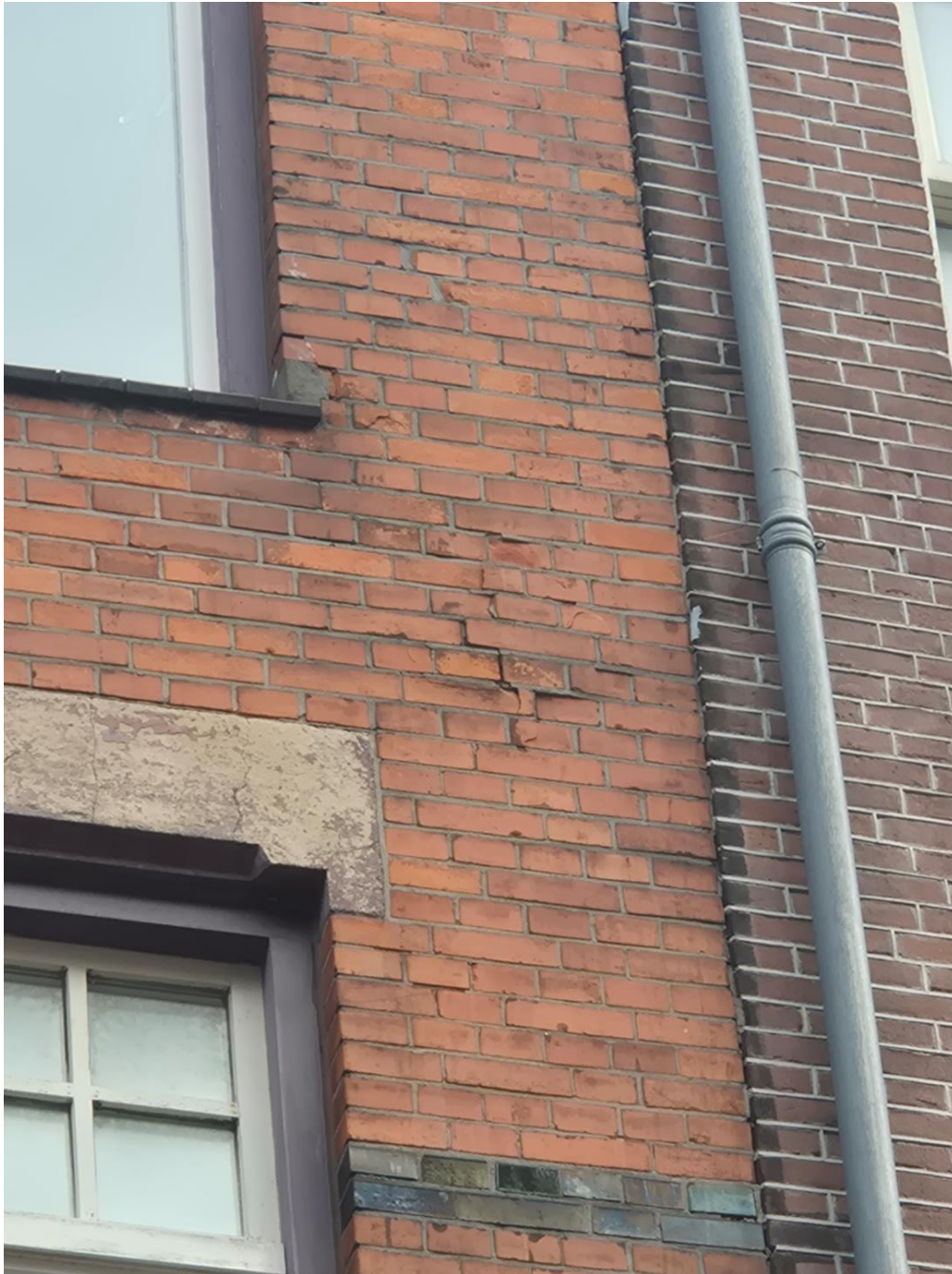
Afbeelding 28: schade in het metselwerk door corroderende achtergelegen gevelankers
