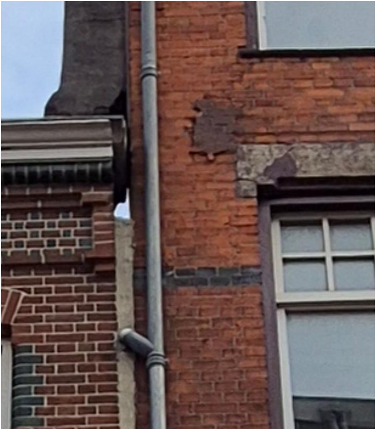
Afbeelding 29: schade in het metselwerk door corroderende achtergelegen gevelankers en nummers 171 en 179 bezitten eigen bouwmuren.
