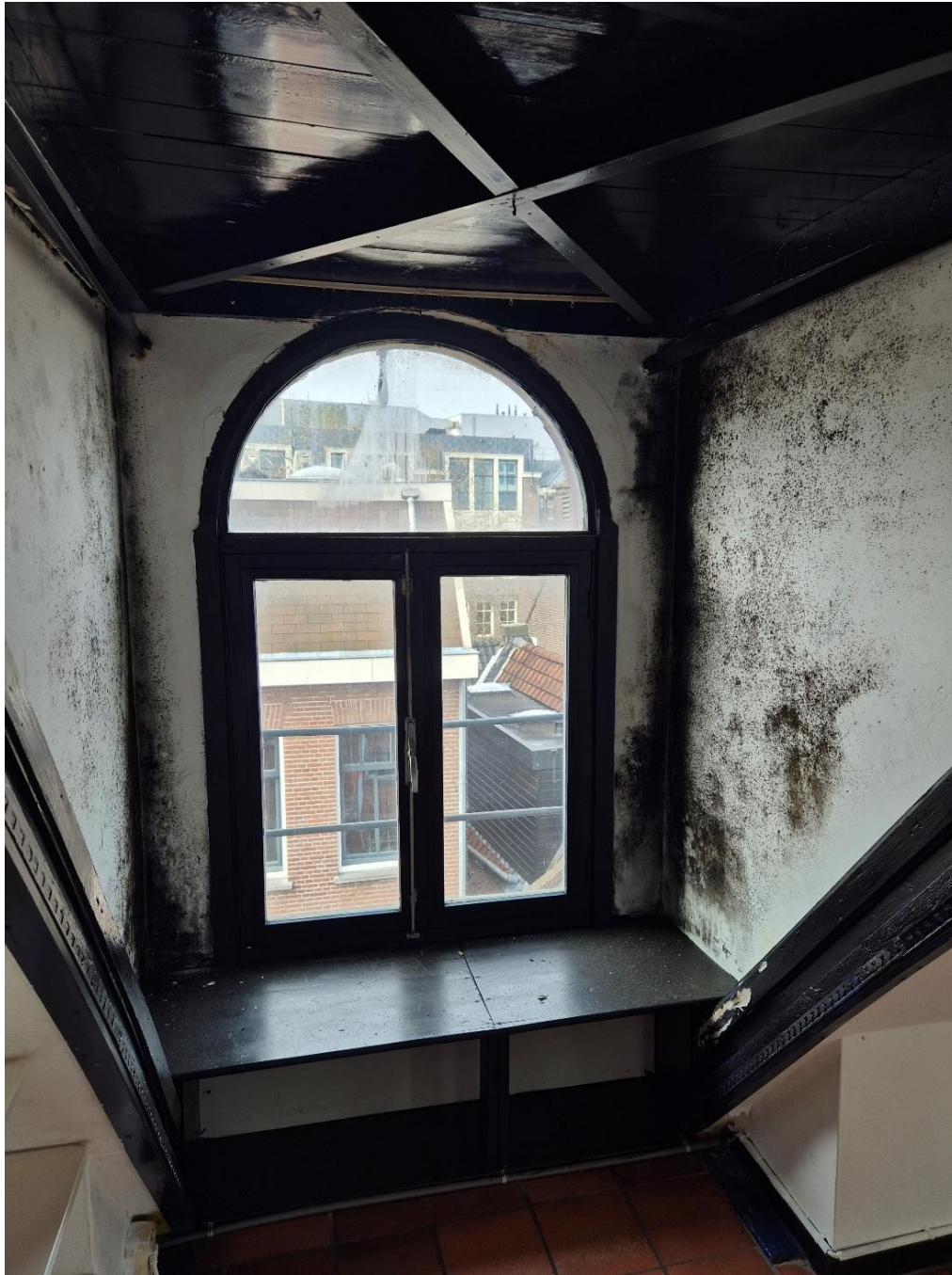
Afbeelding 20: schimmelvorming in de dakkapel gesitueerd aan de voorgevel
