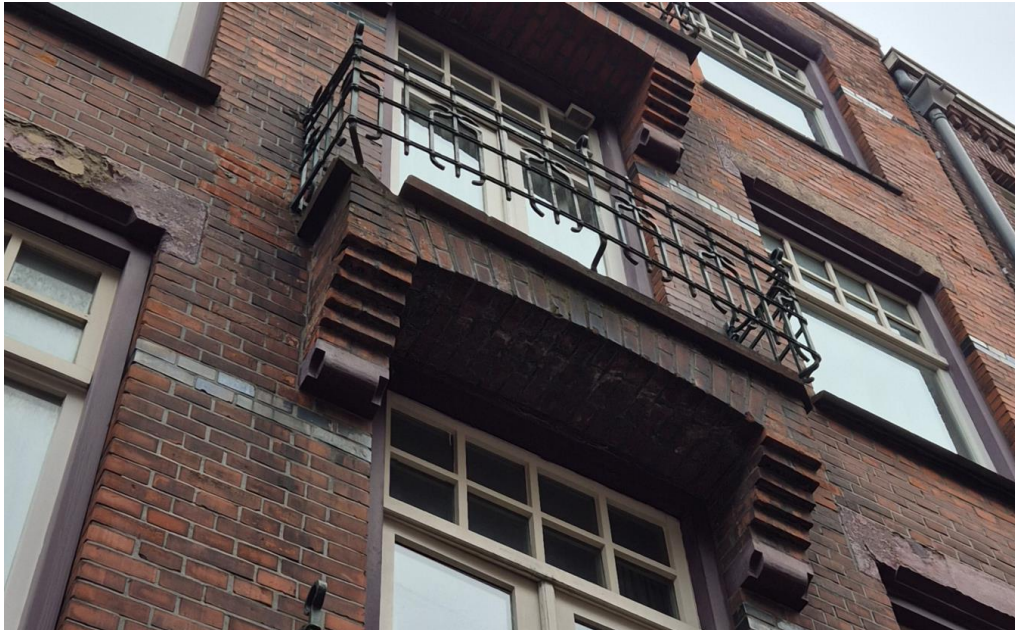
Afbeelding 30: schade aan natuurstenen franse balkon
