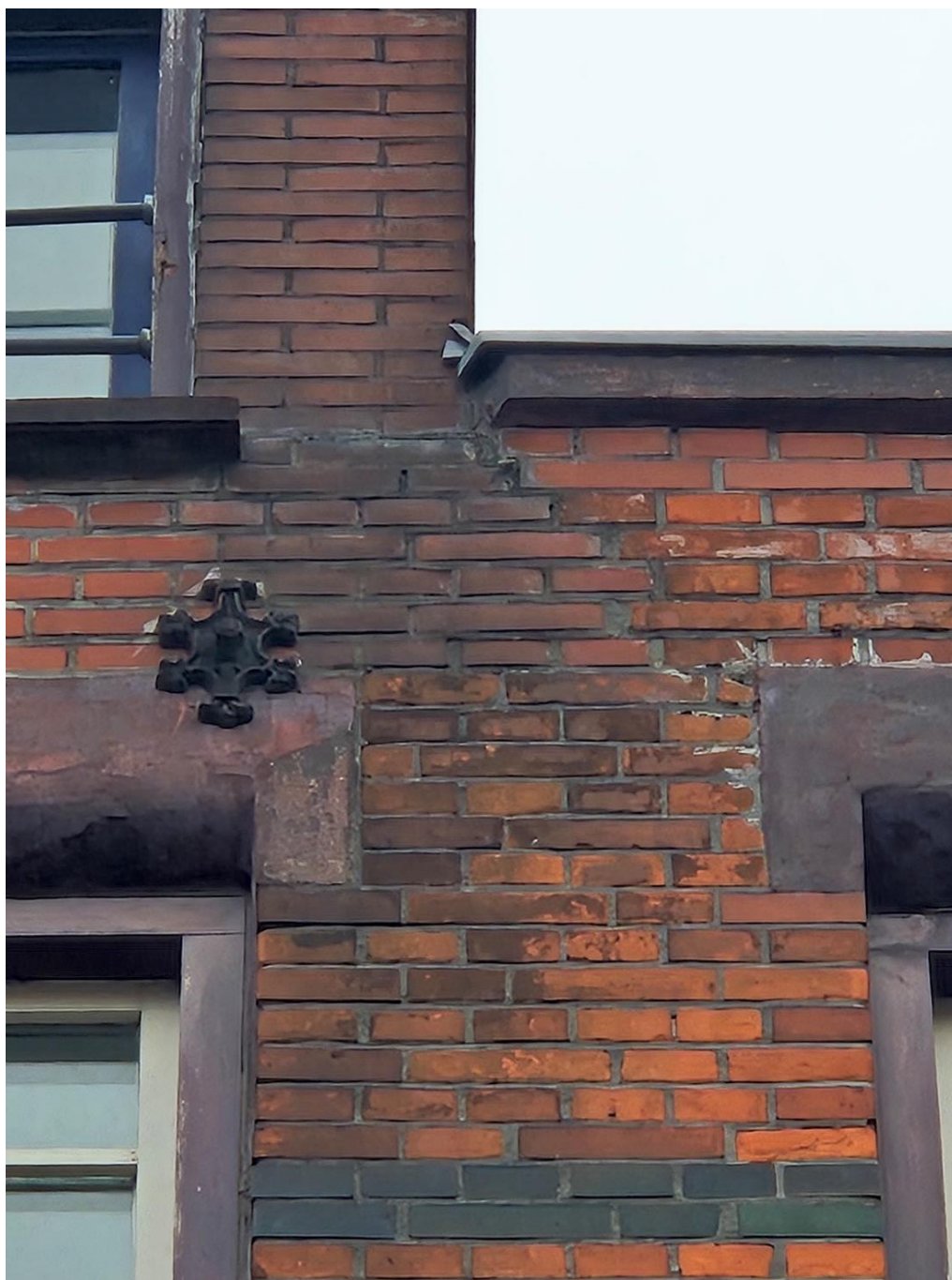
Afbeelding 27: scheurvorming en reparaties in en aan het metselwerk
