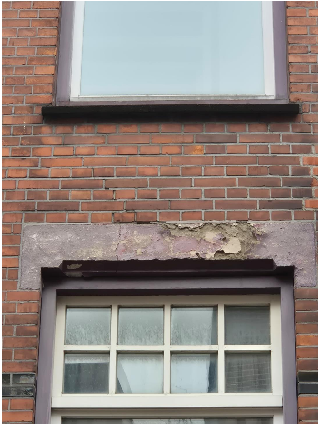
Afbeelding 26: scheurvorming in voorgevel
